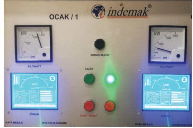
Power Unit Control Panel / Güç Ünitesi Kontrol Paneli
