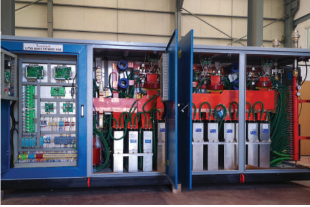
Power Unit / Güç Ünitesi
