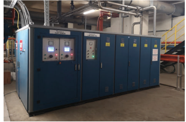
Power Unit / Güç Ünitesi
